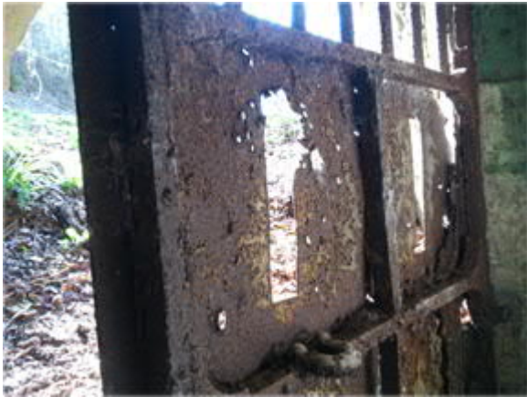
Eine zerschossene Türe der „Pulverkammer“ © Rekonquista
